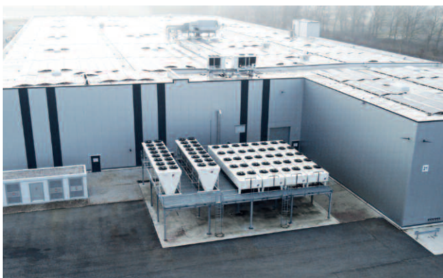
Bild 4: Die Kondensatoren für die Abführung der Abwärme wurden platzsparend auf einer Bühne montiert (© L&R Kältetechnik)
