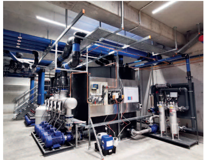
Bild 3: Üblich bei der Kälteversorgung von Extrusionsanlagen: die Pumpen-Tank-Kombination im Keller (© L&R Kältetechnik)
